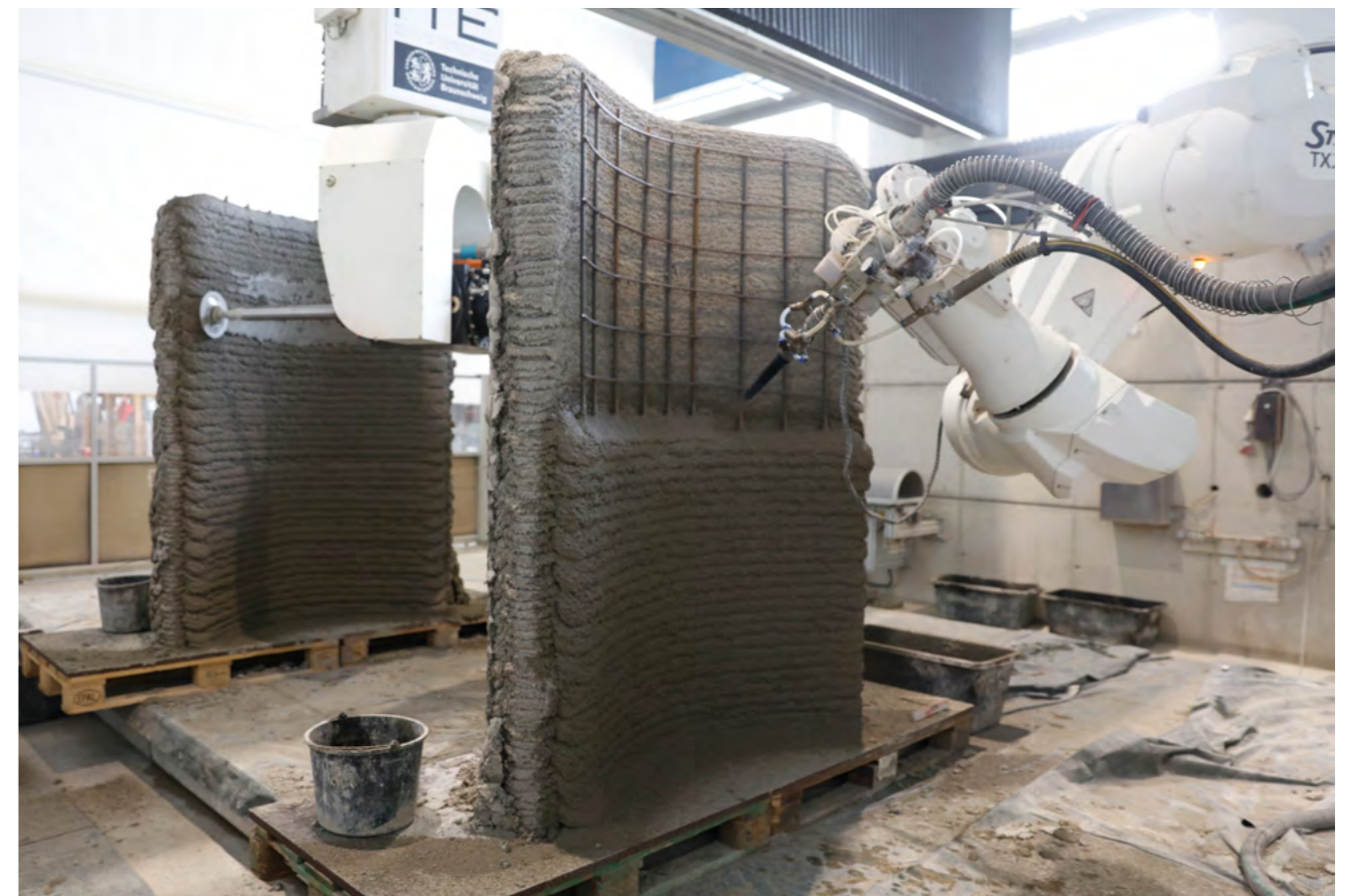
Digitale Fertigung von bewehrten Betonbauteilen im kombinierten Prozess aus Shotcrete 3D Printing und präziser Oberflächenbearbeitung durch CNC-Fräsen entwickelt im AMC Projekt A04 und hier angewendet im DBV-Projekt (PAPER). Foto: Robin Dörrie, Institut für Tragwerksentwurf, TU Braunschweig. Erstellt im Forschungsprojekt Additive Manufacturing in Construction (AMC), Projektpartner:innen: TU Braunschweig und TU München, weitere Partner sind die Leibniz Universität Hannover und das Fraunhofer Institut für Holzforchung, Braunschweig, Förderung: DFG Deutsche Forschungsgemeinschaft, Sonderforschungsbereich Transregio 277, TR277 AMC.
